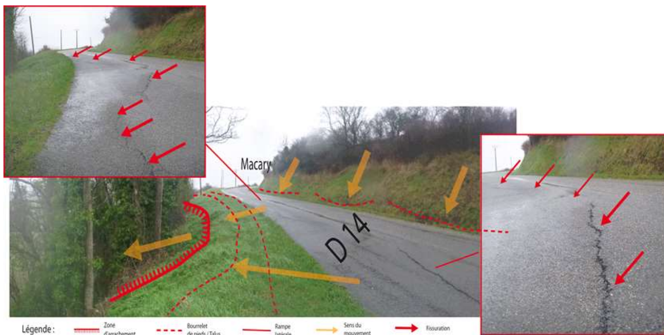
Figure 10: Zone de glissement active sur la route départementale 14 (Source AGERIN)
